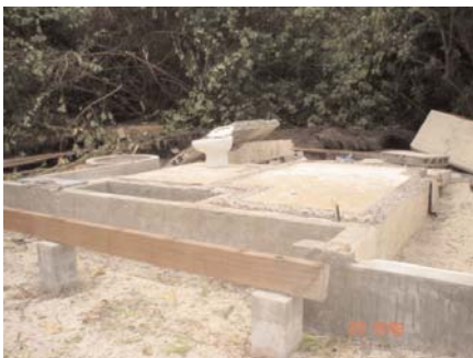
Meedhufushi im Meemu-Atoll. Auf diesem Fundament stand ein Bungalow!
